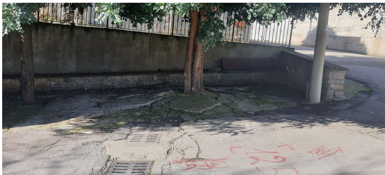
Pavimentazione in calcestruzzo da ripristinare
